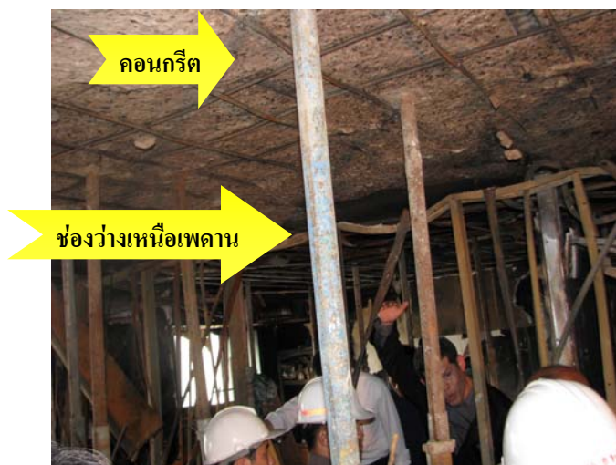
รูปที่ 2 ห้องต้นเพลิงบริเวณห้องนั่งเล่น
