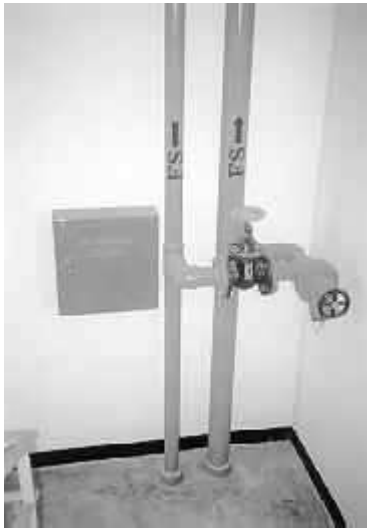
รูปที่ 1 - ท่อส่งน้ำดับเพลิงในบันไดหนีไฟ
