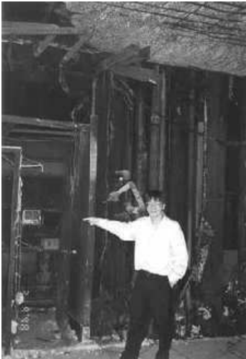
รูปที่ 26 ช่องท่อและประตูหนีไฟที่จัดสร้างไม่ถูกต้อง
