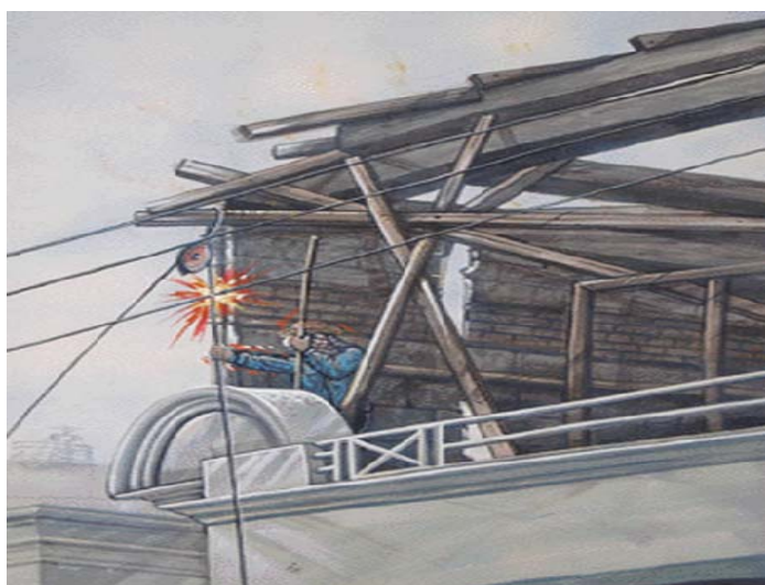
รูปที่ 14 อุบัติเหตุจากการถูกไฟฟ้าช็อตในระหว่างการทำงานก่อสร้าง
