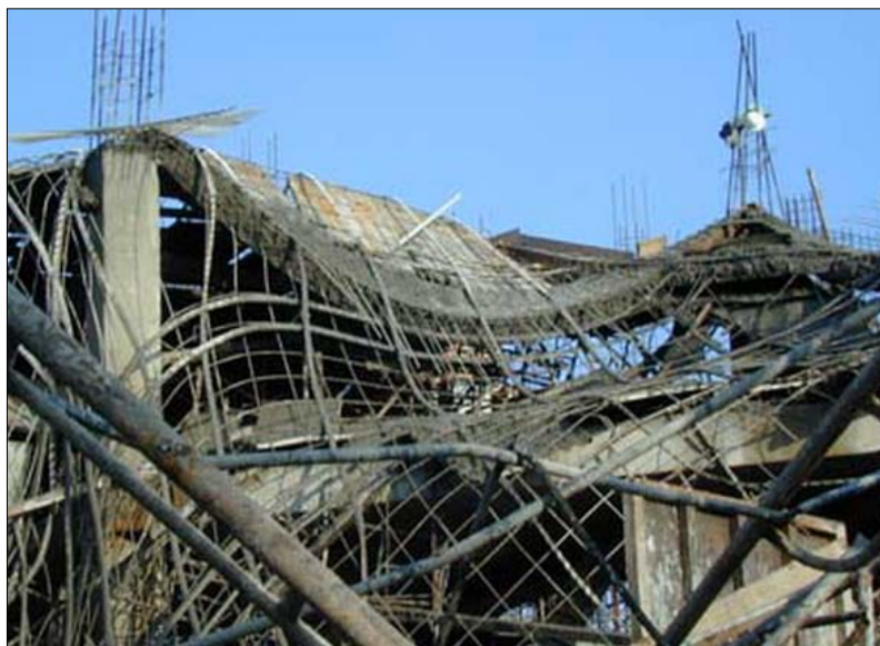
รูปที่ 3 การพังทลายของโครงสร้าง
