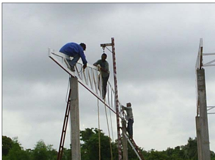
รูปที่ 2 ความประมาทของคนงานก่อสร้าง
